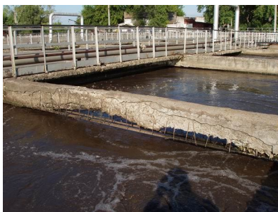
Рис. 6. Очистные сооружения. г.Магнитогорк, левый берег (до ремонта)
