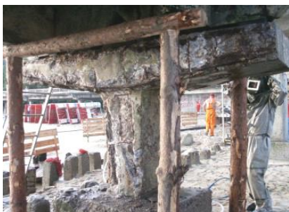
Рис. 3. Пешеходный мост в Калининградской области (до ремонта)
