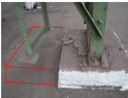
Фото 1. Отсутствие фундамента под опорой газопровода
