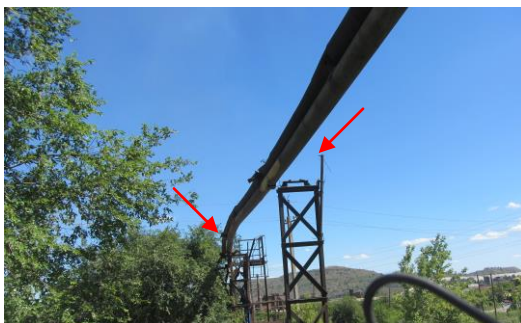
Фото 2. Смещение с опор газопровода и погиб труб в результате механического воздействия (данный участок газопровода располагается над дорогой)
