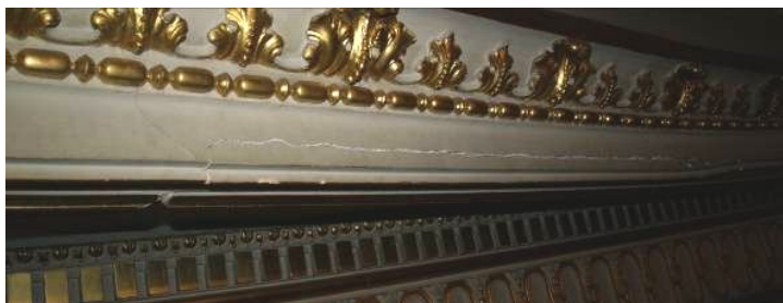
Рис. 19. Трещина в декоративной штукатурке
