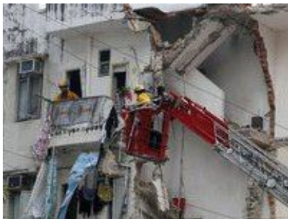
Рис. 4. Обрушение жилого здания в Гонконге
