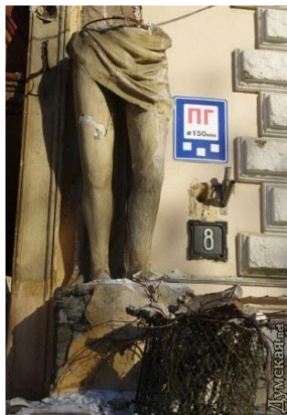
Рис. 11. Обрушение опоры старинного здания
