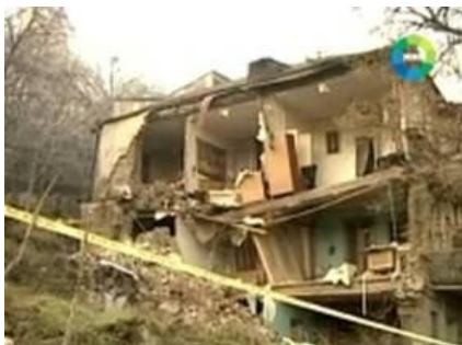
Рис. 2. Обрушение несущей стены жилого трехэтажного дома в г.Тбилиси, Грузия
