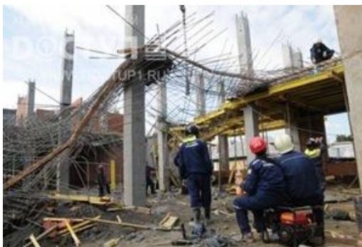
Рис. 9. Обрушение перекрытия строящегося жилого дома в г.Челябинск
