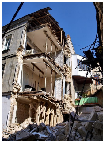
Рис. 8. Частичное обрушение столетнего жилого дома в г.Одесса
