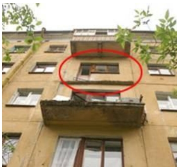
Рис. 13. Обрушение балкона жилого дома в г.Пермь
