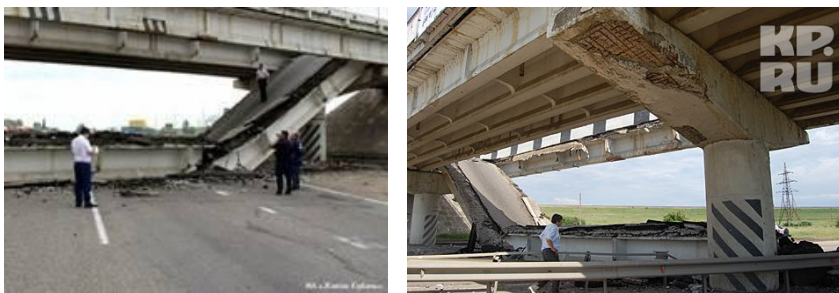
Рис. 18. Обрушение части моста на федеральной трассе М4
