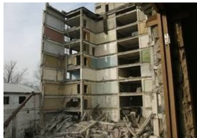
Рис. 1. Обрушение 8-этажного здания
