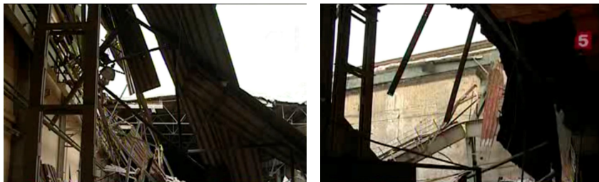
Рис.15. Обрушение кровли в недействующем капитально ремонтируемом цехе Кировского завода
