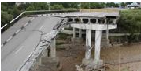
Рис. 20. Обрушение автомагистрала в г.Нанту (Тайвань)
