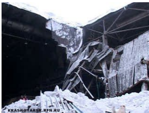
Рис. 16. Обрушение крыши цеха термообработки г.Красноярск
