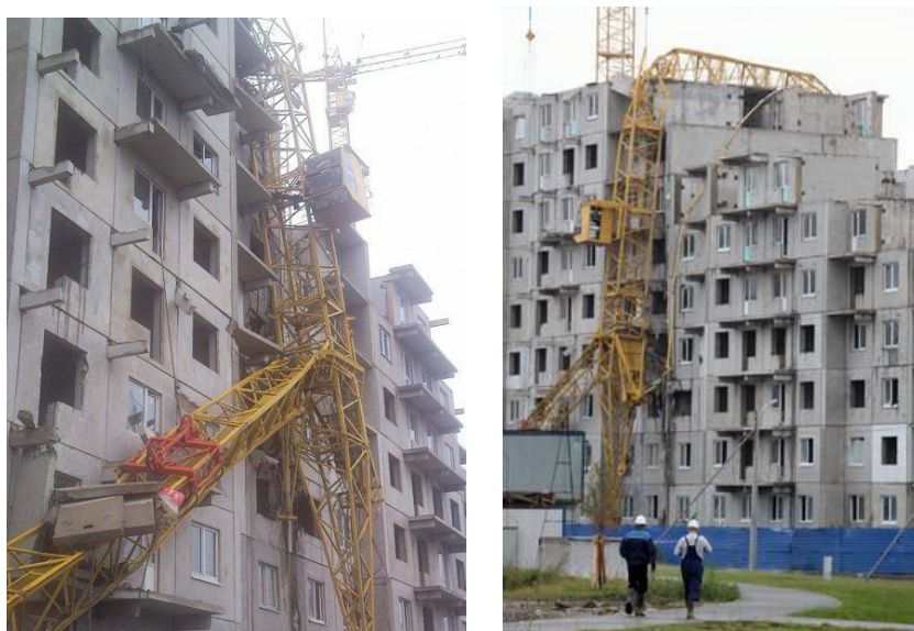
Рис. 22. Падение двух башенных кранов в г. Санкт-Петербурге
