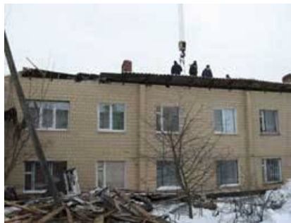
Рис. 5. Обрушение крыши многоквартирного жилого двухэтажного дома в г.Чернигов, Украина
