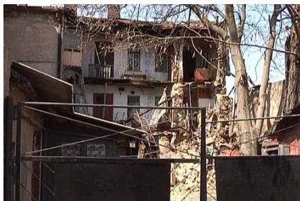
Рис. 7. Обрушение трехэтажного жилого дома в г.Одесса
