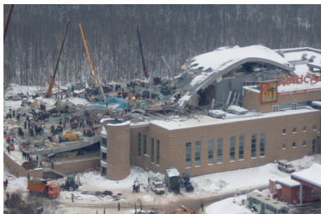
Обрушение «Трансваальпарка» в Ясенево
