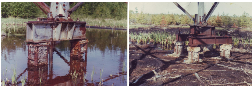
Рис. 1. Свайные фундаменты опор ЛЭП, находящиеся в аварийном состоянии
