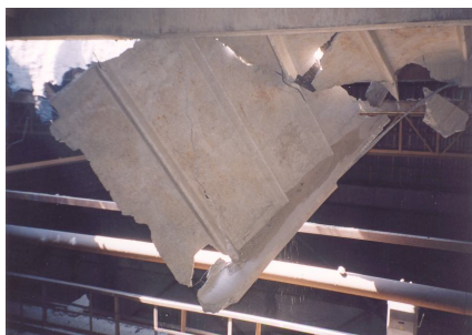
Рис.5. Обрушение плиты покрытия
