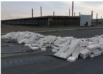
Рис. 1. Характерное нарушение правил проведения строительно-монтажных работ
