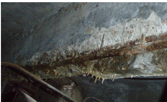
Рис.2. Коррозия бетона поперечной балки с оголением и коррозией рабочей арматуры (5%) здания производственного корпуса цеха Н-5 ОАО «Стерлитамакский нефтехимический завод», г. Стерлитамак ( S_{\text{общ}}=1,2 \text{ м}^2 )
