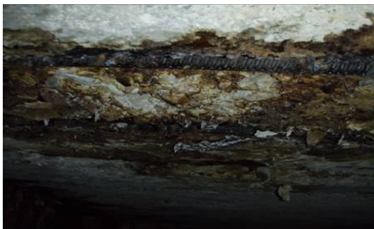
Рис. 3. Коррозия бетона мелкозернистых плит с оголением рабочей арматуры здания производственного корпуса цеха Н-5 ОАО «Стерлитамакский нефтехимический завод», г. Стерлитамак ( S=0,5 \text{ м}^2 )
