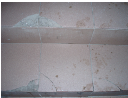
Рис. 1. Дефекты керамических плит в облицовке лестничных ступеней, разрушения, и трещины
