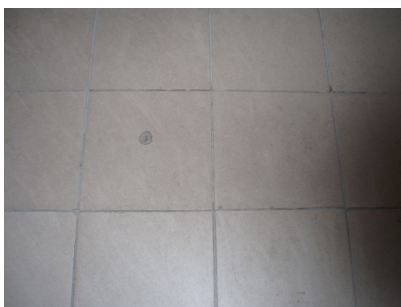
Рис. 2. Точечные выбоины на керамических плитах
