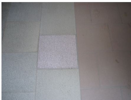
Рис. 3. Нарушение уровня и эстетики пола при замене дефектных плит
