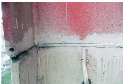
Рис. 3. Трещина в шве ребра жесткости одной из стальных дымовых труб
