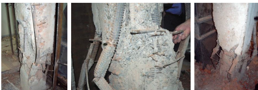
Рис. 3. Разрушение стыков железобетонных колонн кардиологического центра в г. Кемерово
