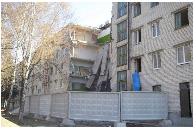
Рис. 1. Общий вид обрушившейся части здания
