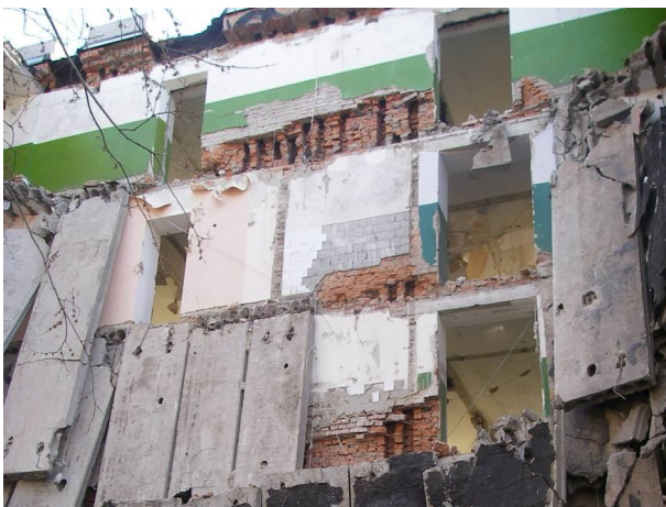
Рис. 3. Вид средней несущей стены после аварии
