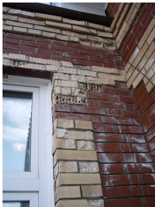
Рис. 3. Повреждения кладки стены блока конюшен в осях Г-Д/4
