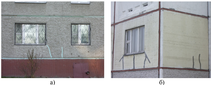
Рис. 2. Типичное расположение трещин в двухмодульных (а) и одномодульных (б) панелях
