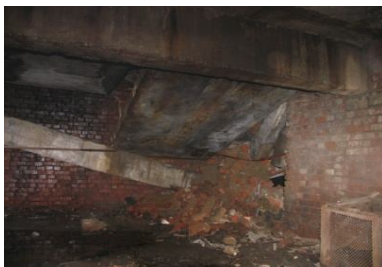
Рис. 2. Участок обрушения, вид в осях «А-Б»
