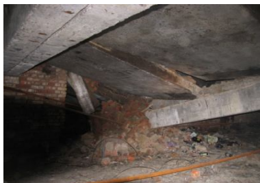
Рис. 3. Участок обрушения, вид в осях «Б-В»
