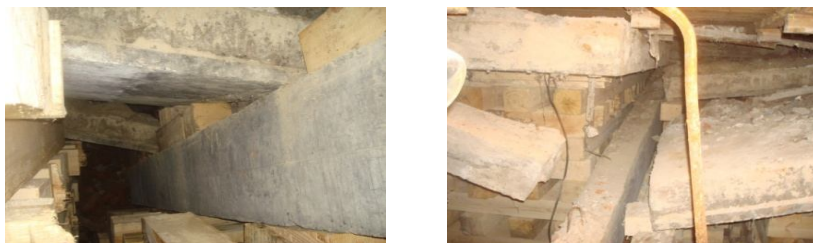
Рис. 5. Фиксации обрушившихся конструкций в положении, зафиксированном на момент обрушения
